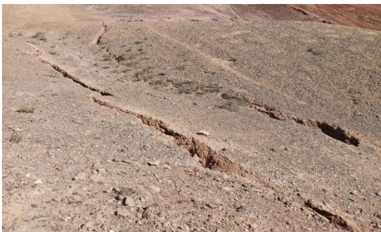
照片 3-2-6 现状地面塌陷区
