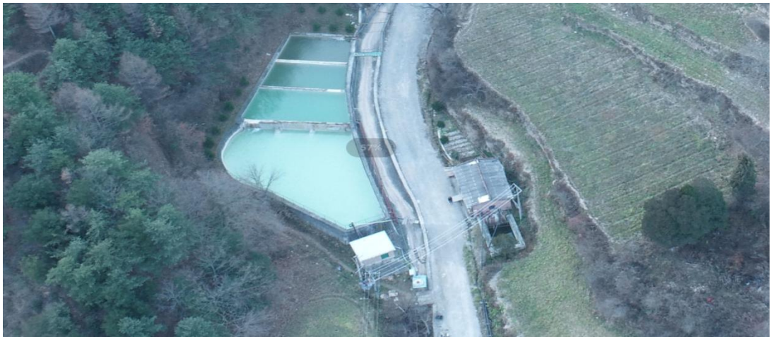
照片 3-8 尾矿库污水处理设施现状
