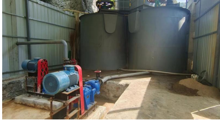
照片 1-1 充填站设施图
