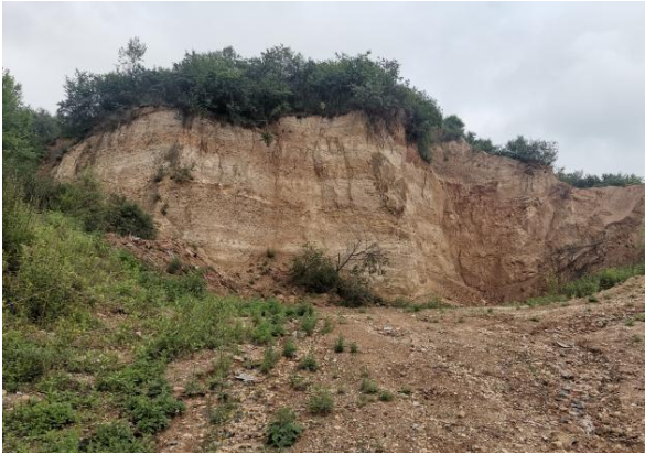
照片 3.2-6 X3 不稳定斜坡
