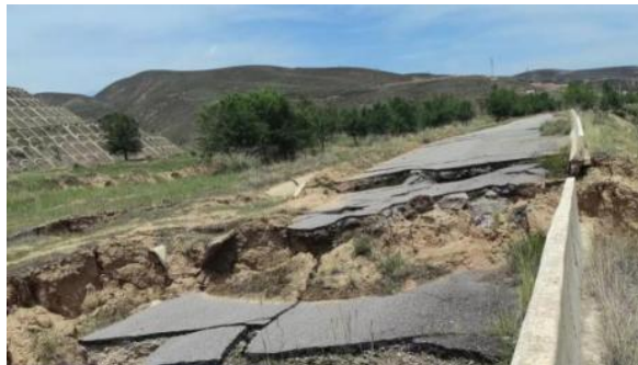
图 3.2-4 不稳定斜坡坡顶坍塌损毁道路
